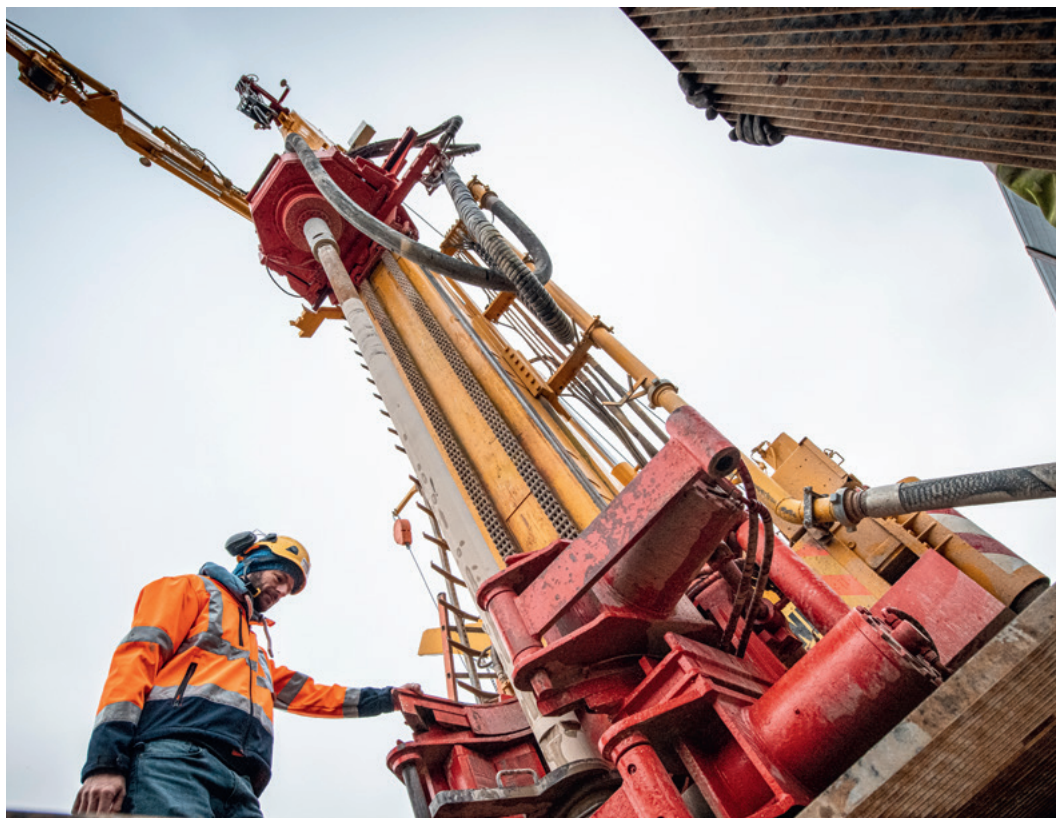
Forage géothermique réalisé à proximité de Satigny, dans le cadre du programme GEothermies.
